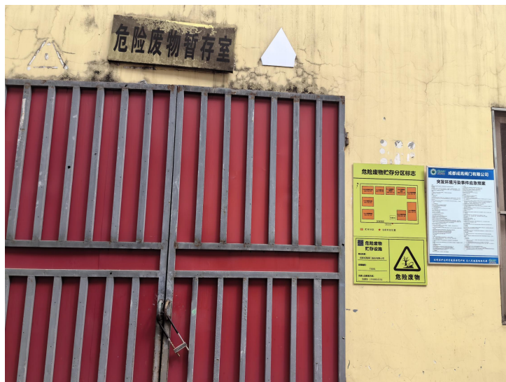
危废暂存间标识标牌
